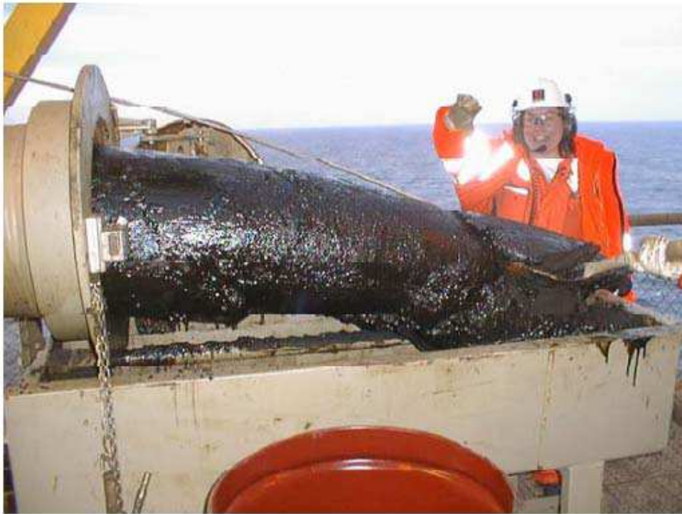
Figura 2-Entupimento de uma tubulação na plataforma C no Mar do Norte (LABES-CARRIER et al. , 2002)
